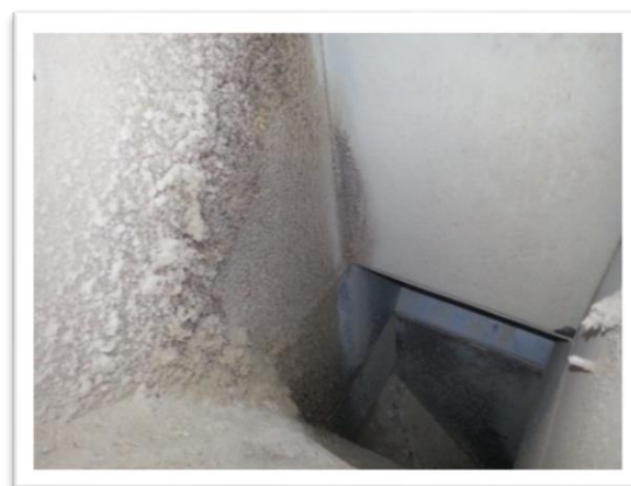
Figure 1 : Dépôt en face de la buse de traitement
